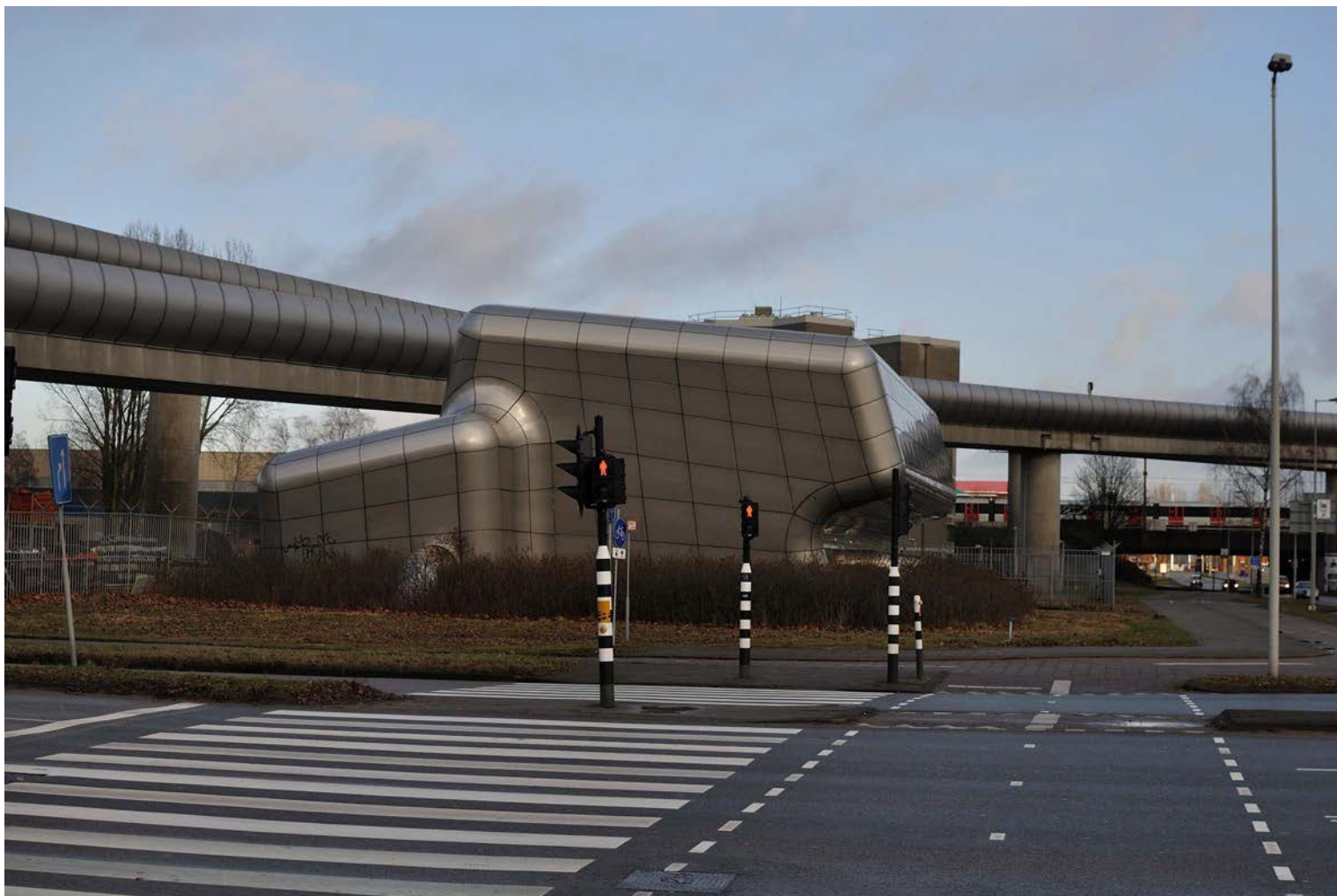
Spaklerweg, Boostergemaal Maarten van Bremen, 2007
